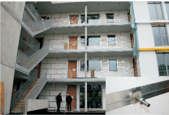
Montierte QASA-B1-Fläche in München, Ackermannbogen (Architekt Werle)
